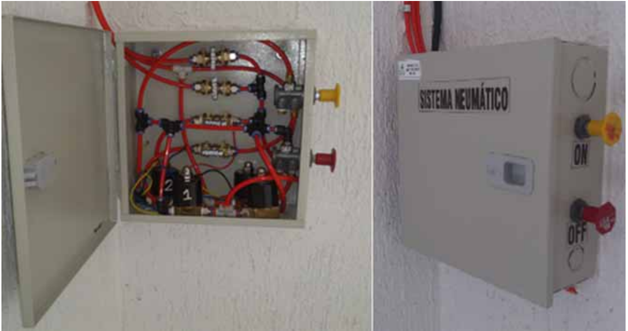
Figura 12. Tablero de control de sistema neumático.
