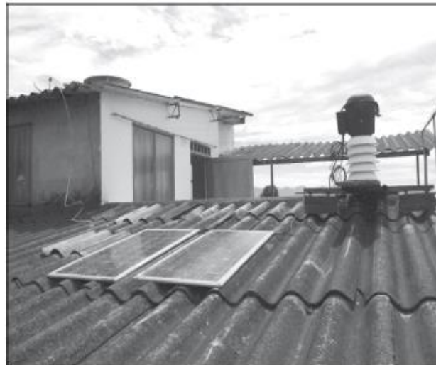
Fig. 5. Módulo Estación operando, SEA-USCO
